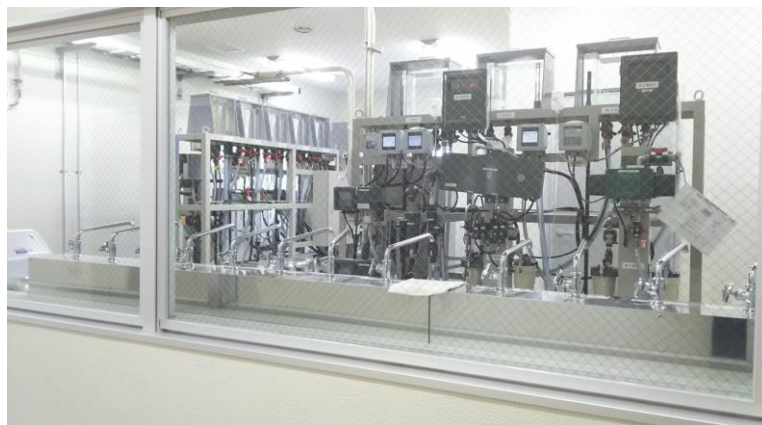
連続水質測定計器 石川浄水場
