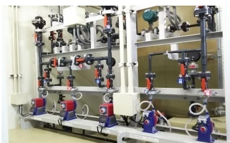
苛性ソーダ自動注入設備(石川浄水場内)
