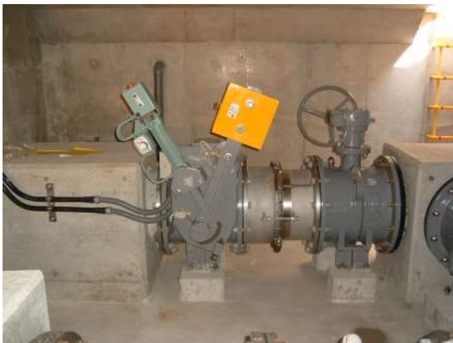
緊急遮断弁（高区配水池）
