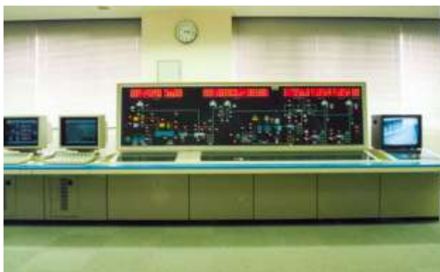
〔中央監視設備〕
