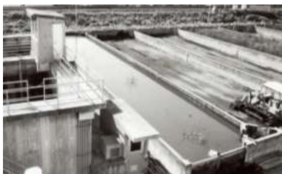
〔石川浄水場汚泥処理設備〕
