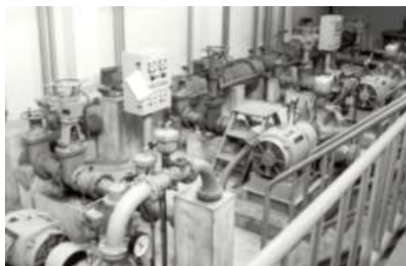
〔石川浄水場送水ポンプ設備〕
