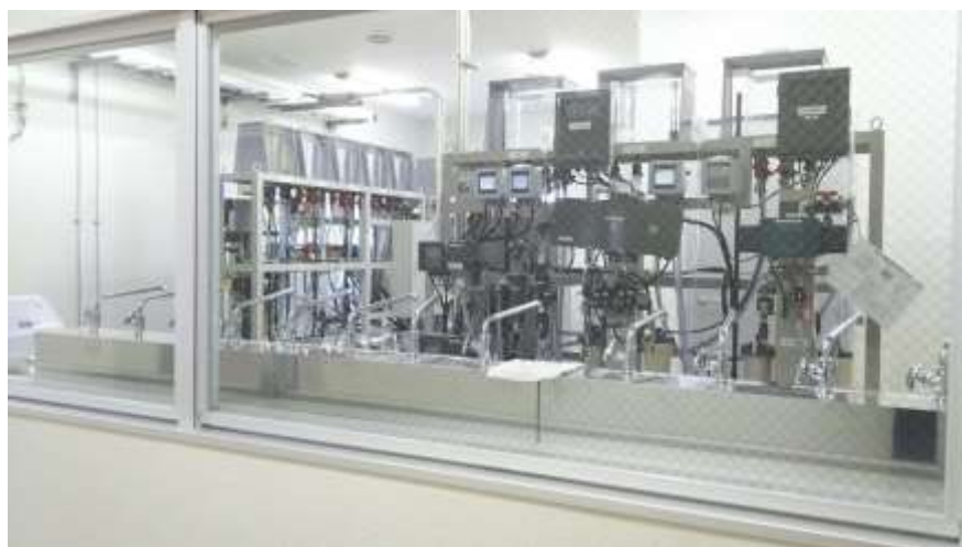
連続水質測定計器 石川浄水場
