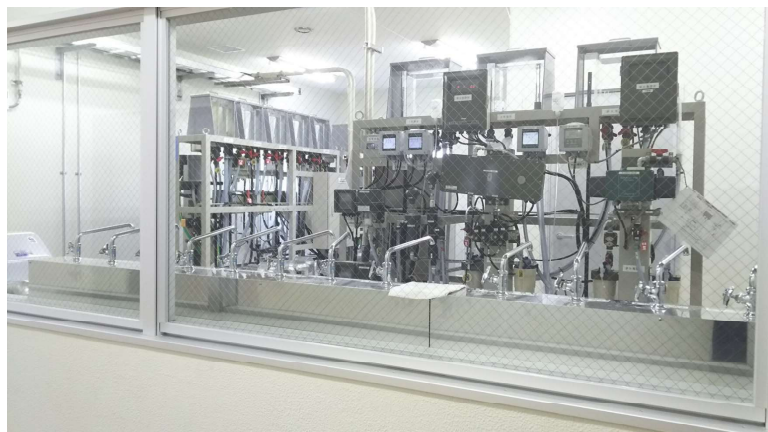
連続水質測定計器 石川浄水場
